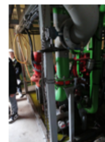
Cogénération Centrale biogaz Roche la Molière
